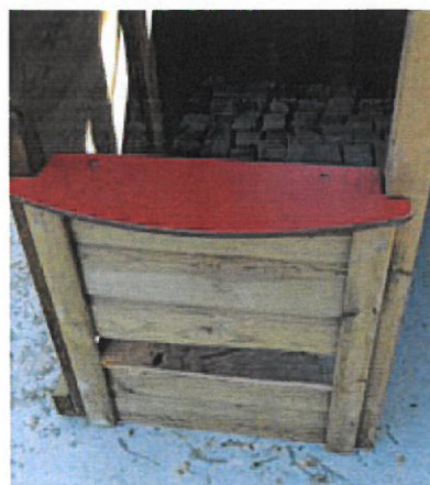
Dégradation du tout nouveau chalet de l'aire de jeux de l'Espace Papanou
