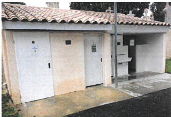
Dégradation des WC publics de l'Espace Papanou
